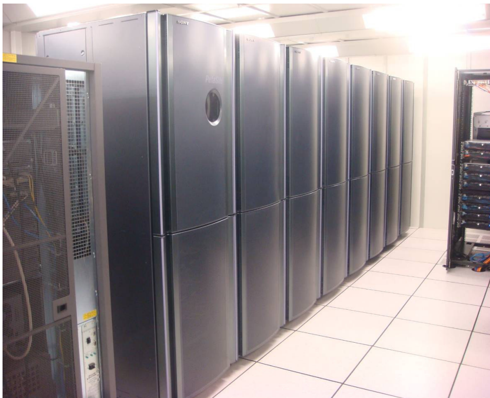
Figura 10 - Robótica de armazenamento na Sala Cofre do Prodasen Fonte: Acervo do CEDOC Multimídia
