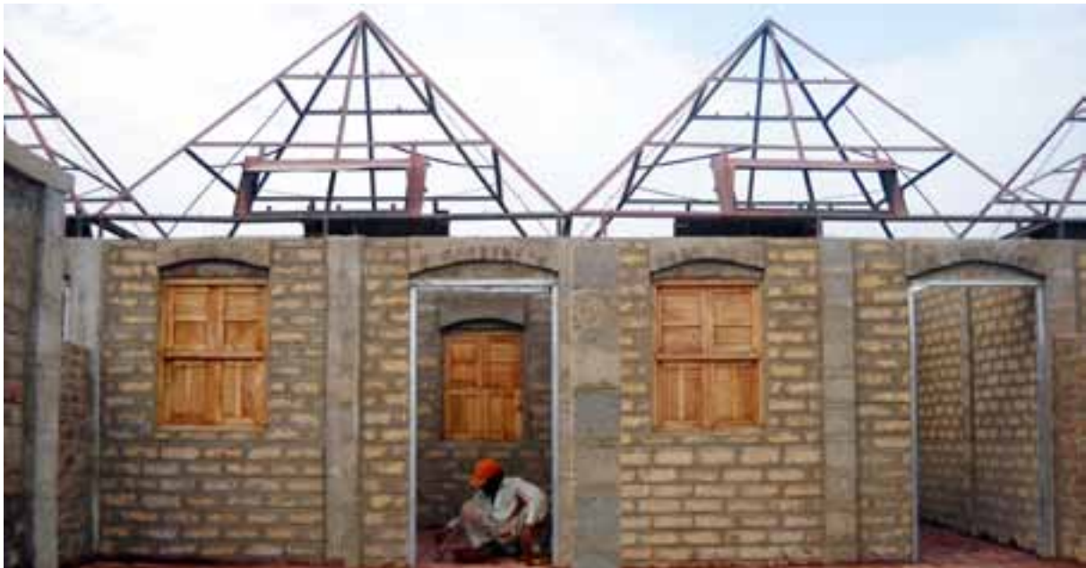
Construcción de viviendas que respetan la eficiencia energética y la sostenibilidad medioambiental en el distrito rural de Thatta (Pakistán). El proyecto principal fue ejecutado por UNOPS en nombre del Programa de Pequeñas Donaciones del FMAM-PNUD. Fotografía: Masood Lohar
