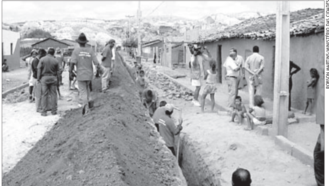
Obra de saneamento em Guaribas, no Piauí: projetos buscam garantir serviços a toda a população
