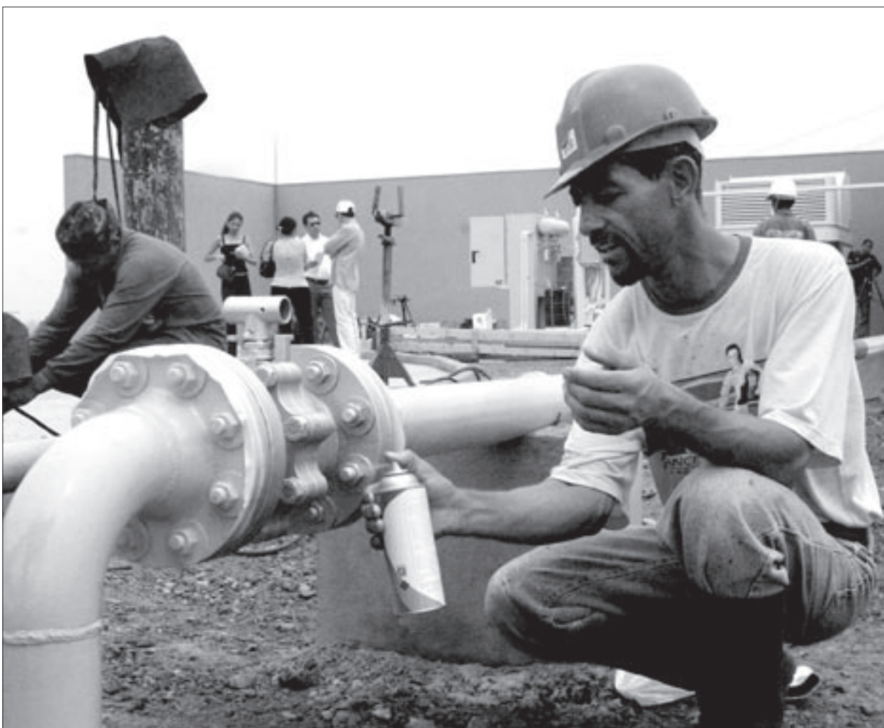
Operários fazem trabalho de manutenção: Petrobras quer construir mais 6 mil quilômetros de dutos até 2011
