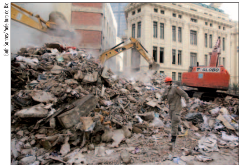
Desabamento de três prédios no Rio, em janeiro, é citado pelo relator do projeto
