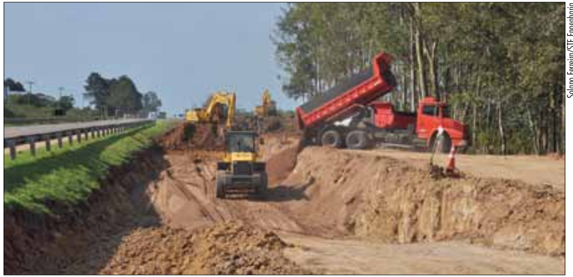
Obras de duplicação de rodovia em Pelotas (RS), onde o TCU encontrou indícios de irregularidades financeiras
