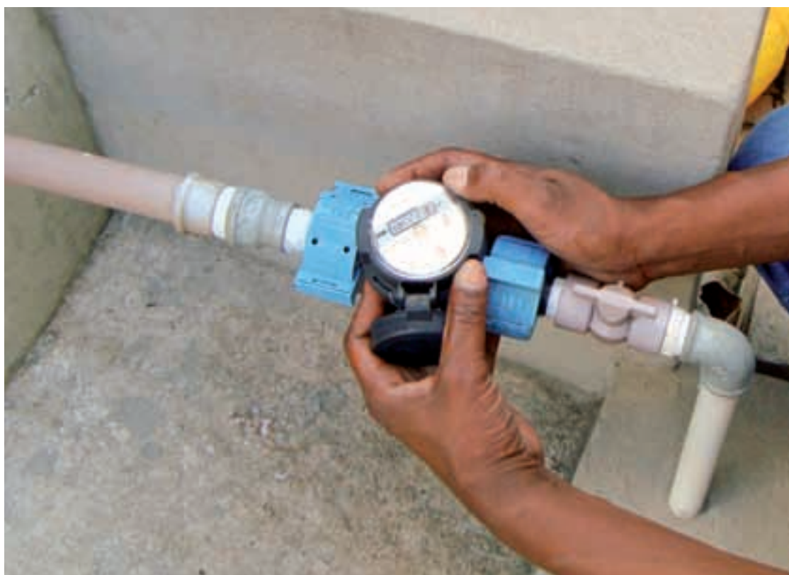
Medidor de consumo de água: proposta estabelece prazo de cinco anos para condomínios se adaptarem à nova norma
