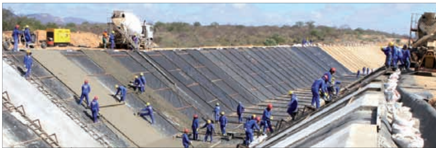
Obras em Cabrobó (PE): Cícero destaca que, pela previsão inicial, a transposição de águas já deveria estar pronta, mas avançou apenas 43%
