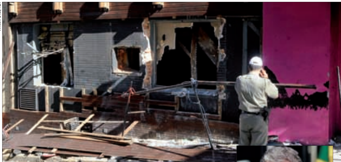
A boate Kiss, após o incêndio que matou 239 pessoas; ao lado, Jorge Viana
