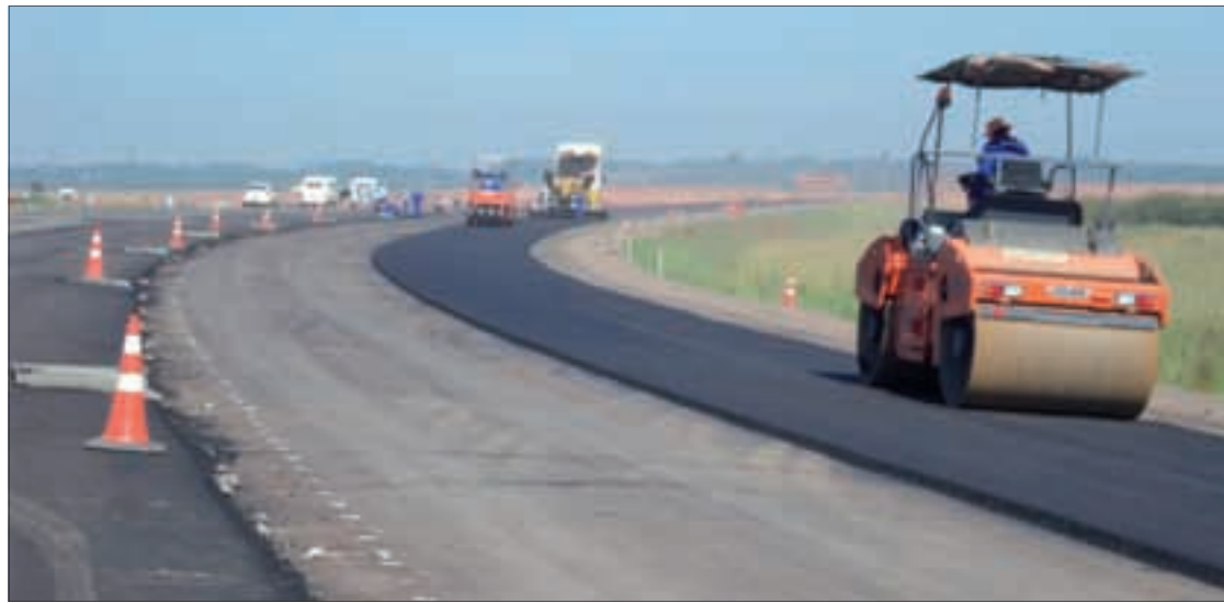
Obra na BR-448, no Rio Grande do Sul: auditoria encontrou falhas em rodovias federais, que são administradas pelo Dnit
