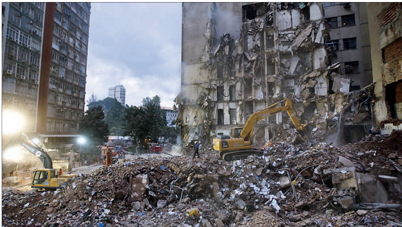
Em 2012, ano em que o projeto de lei foi apresentado no Congresso, o desabamento do Edifício Liberdade, no Rio de Janeiro, matou 17 pessoas
