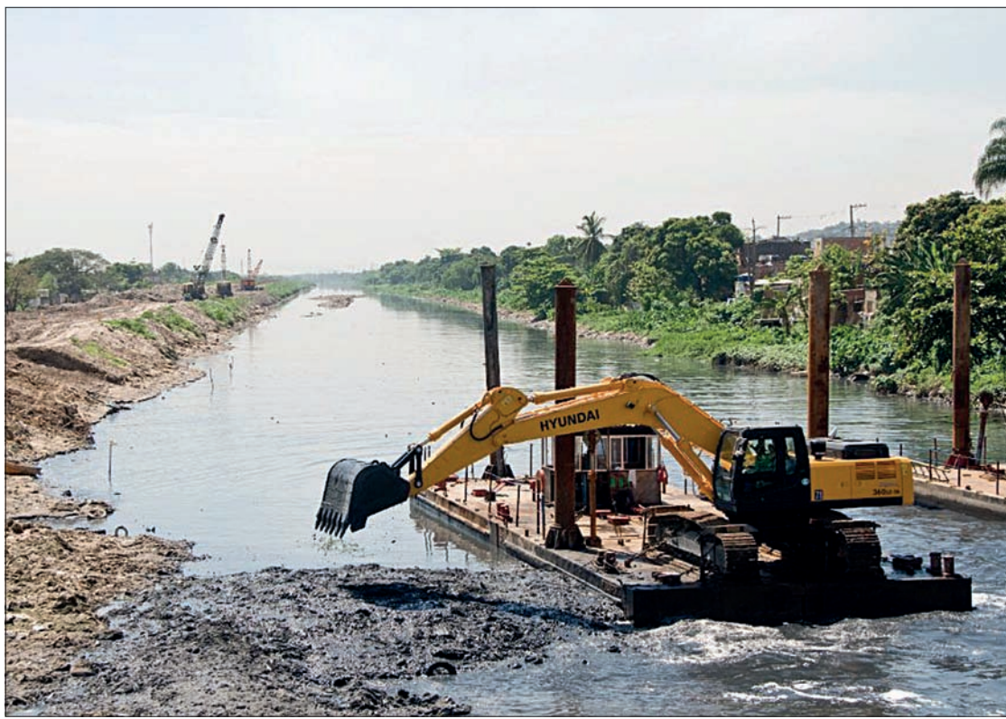
Projeto de controle de inundações na Baixada Fluminense é uma das obras com irregularidades apontadas pelo TCU
