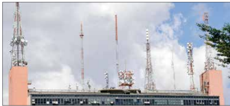
Antenas de telecomunicações em Brasília: regras agora dependem do Planalto
