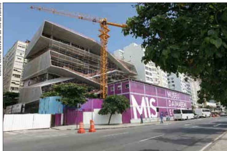
Obras do Museu da Imagem e do Som (MIS), no Rio, que terá captação da chuva
