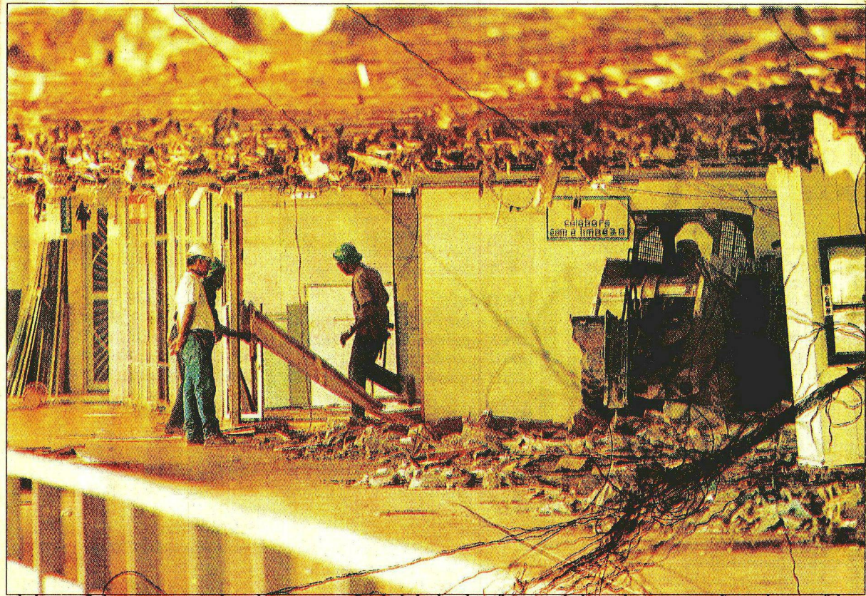
Até que o Iphan aprove projeto de reconstrução da laje da plataforma, só obras de manutenção podem ser feitas
