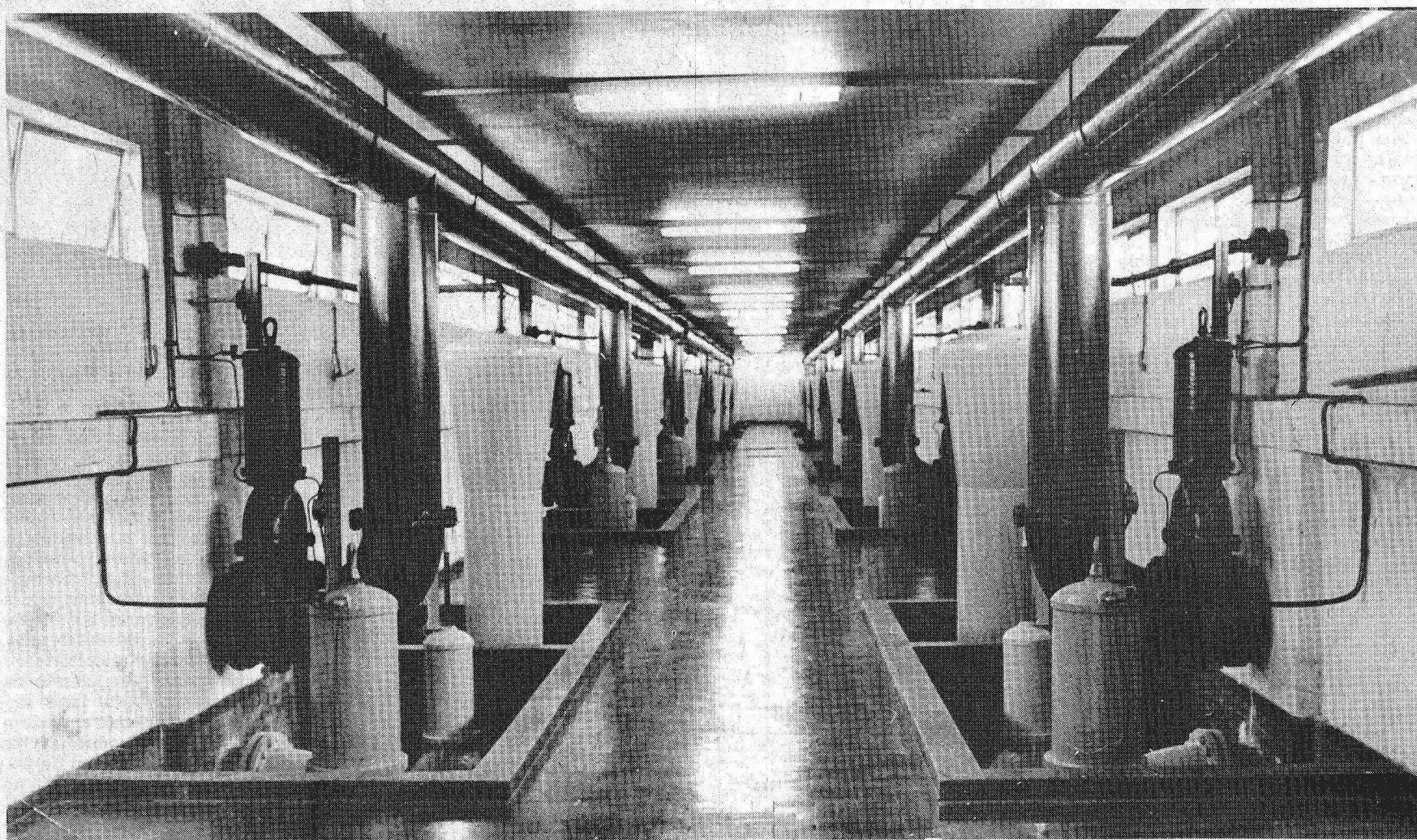
Estação de tratamento de água da CAESB
