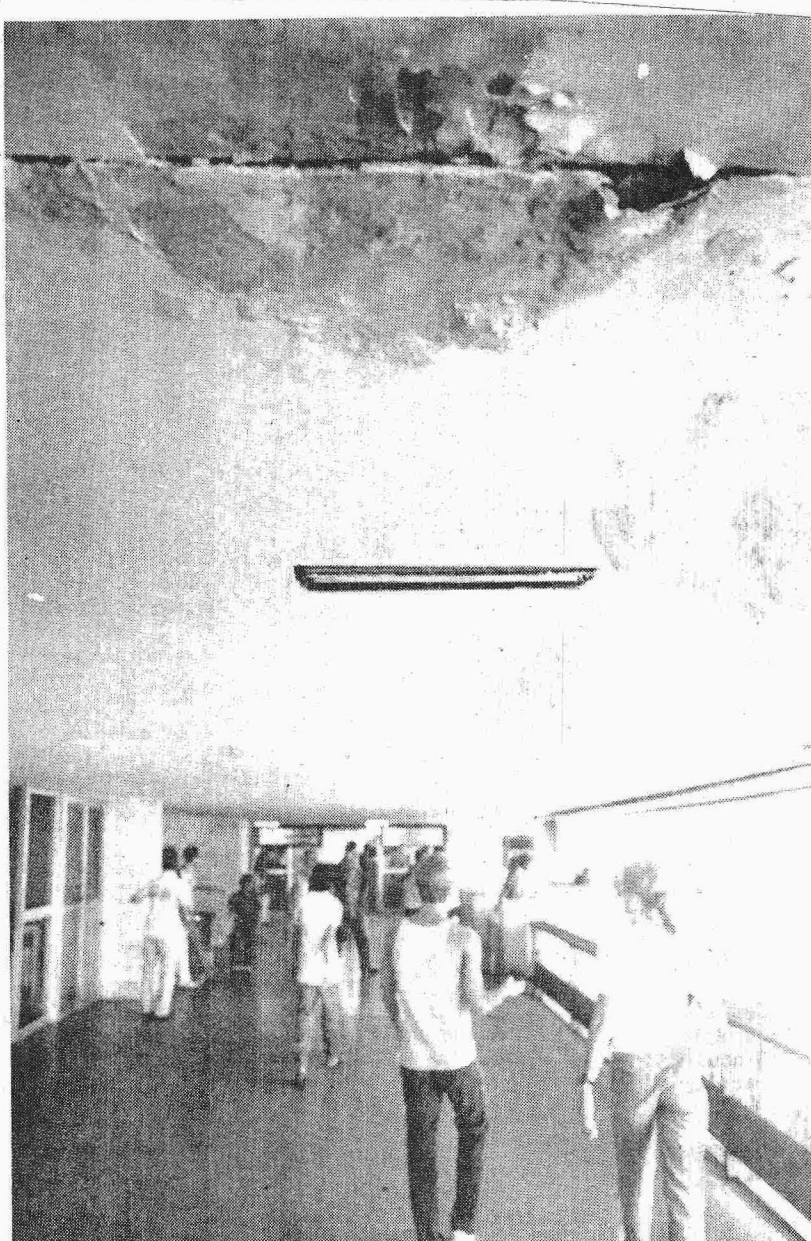
Infiltrações no teto são um perigo constante para passageiros
