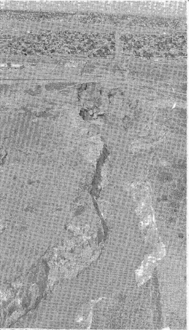
Na Ceilândia, erosão retrata avanços da degradação
