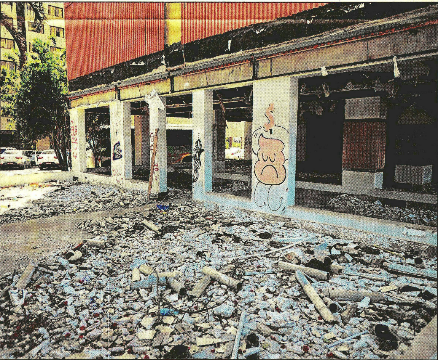
O Hotel Torre Palace agora hospeda a população em situação de rua e consumidores de entorpecentes: paredes caídas e muito lixo
