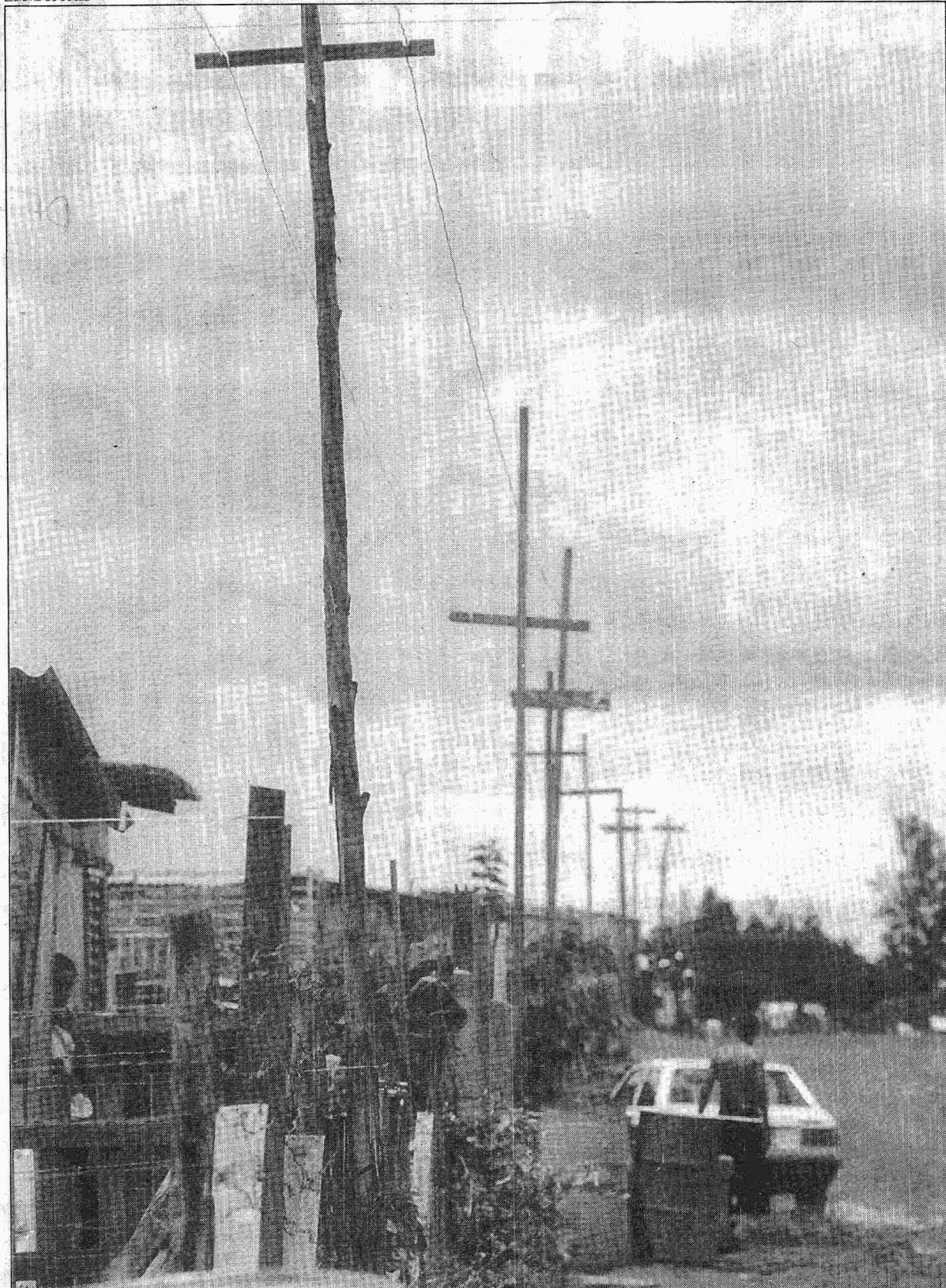
As gambiarras estão por toda a invasão, em postes de madeira, mas os moradores tentam disfarçar a irregularidade
