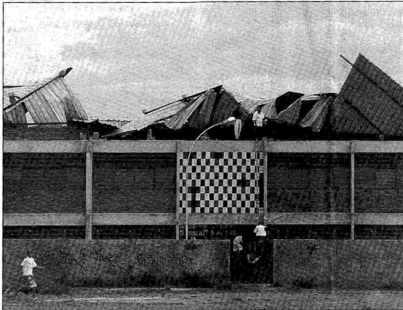
A cobertura de zinco saiu de cima das salas e caiu na área de recreio do colégio
