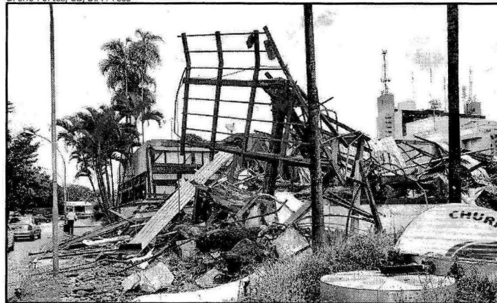
Fiscais derrubaram 300 metros quadrados do restaurante Chamas Grill
