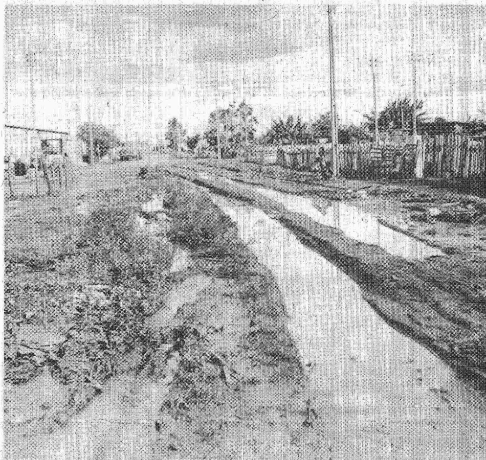
Moradores, para não terem roubadas suas torneiras e registros, retiram-nas à noite e a água fica escorrendo para a rua
