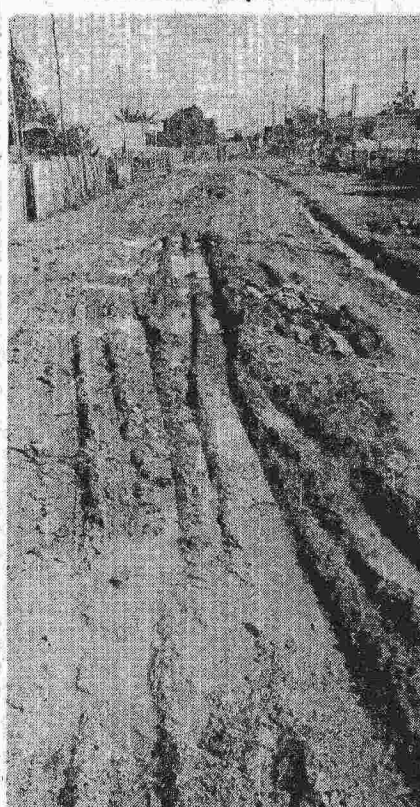
Ausência de asfalto
