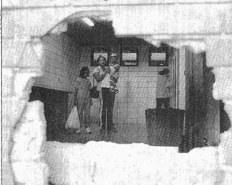
Banheiro feminino: buraco grande o suficiente para uma pessoa passar
