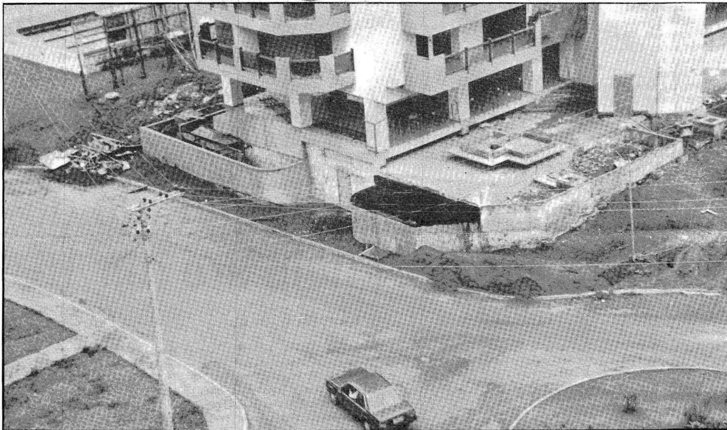
Antes de ficar pronta, a garagem do edifício em construção na 309 Norte já começa a apresentar problemas
