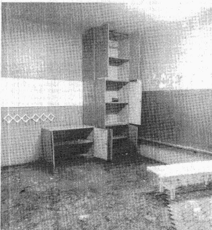
Jardim da 404 Norte: infiltrações arruinaram o piso
