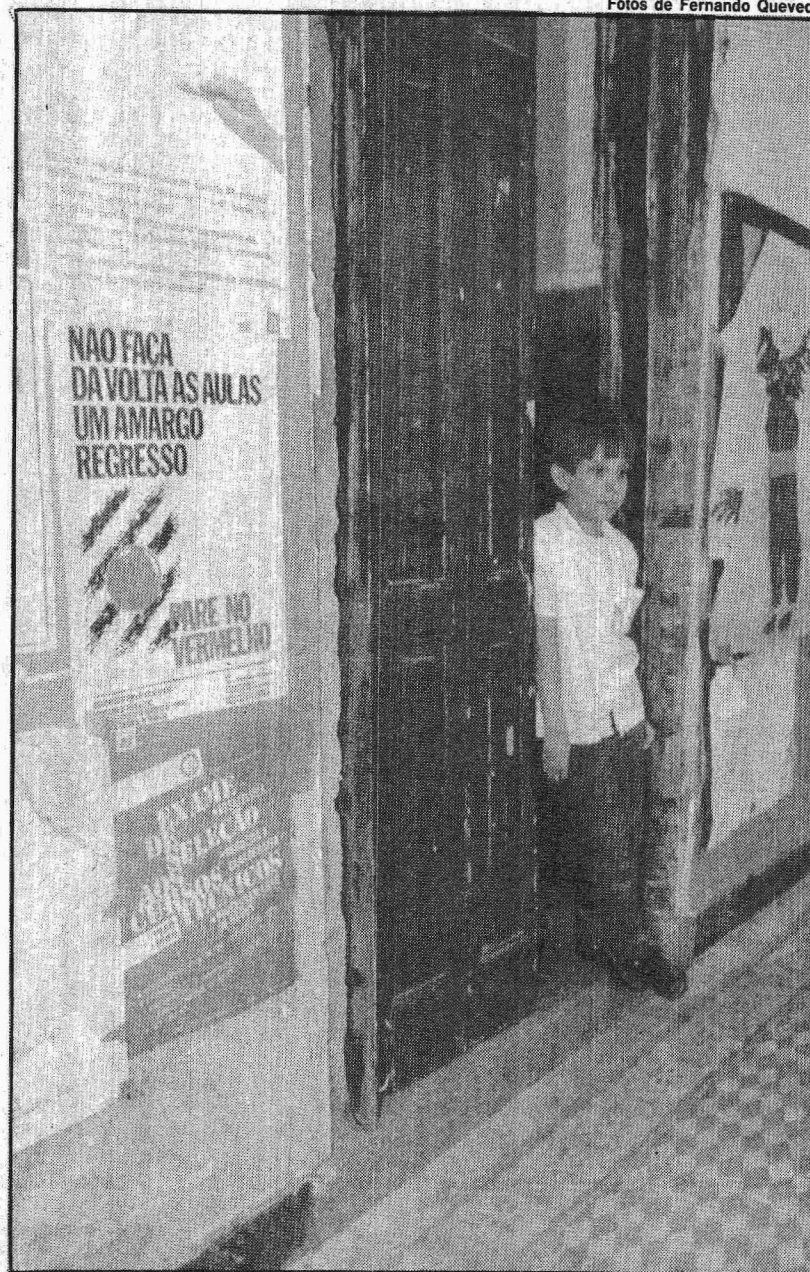
O aluno encosta na porta quebrada da Escola Leite da Cunha, na Tijuca
