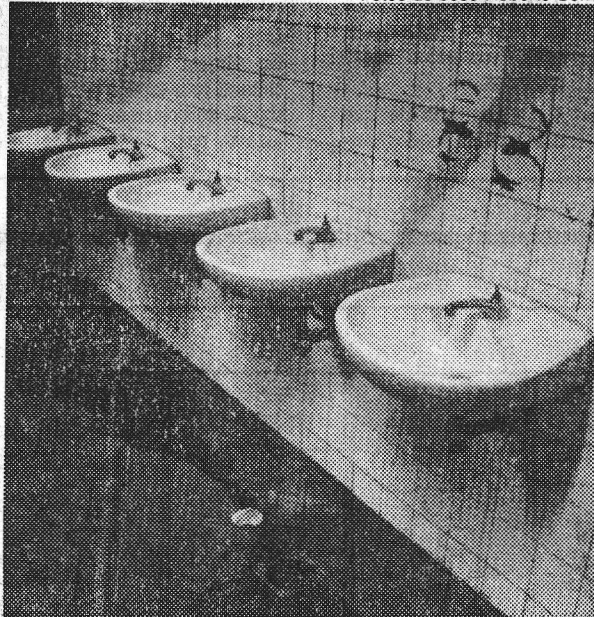
Ciep Rua do Lavradio: pias sem torneiras
