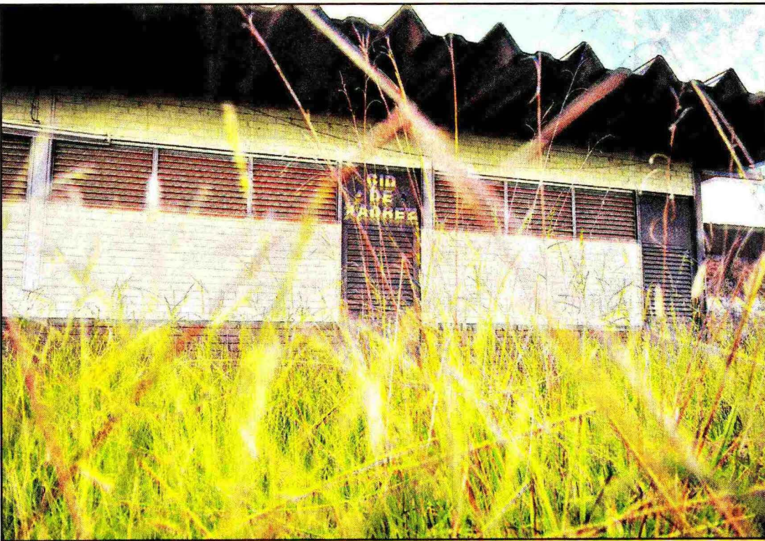
No Centro Educacional 7 de Ceilândia, alunos reclamam de calor e de barulho por causa de problemas no teto
