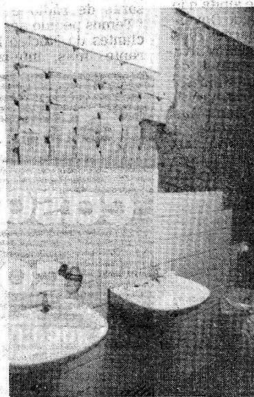
Banheiro: avarias e sujeira
