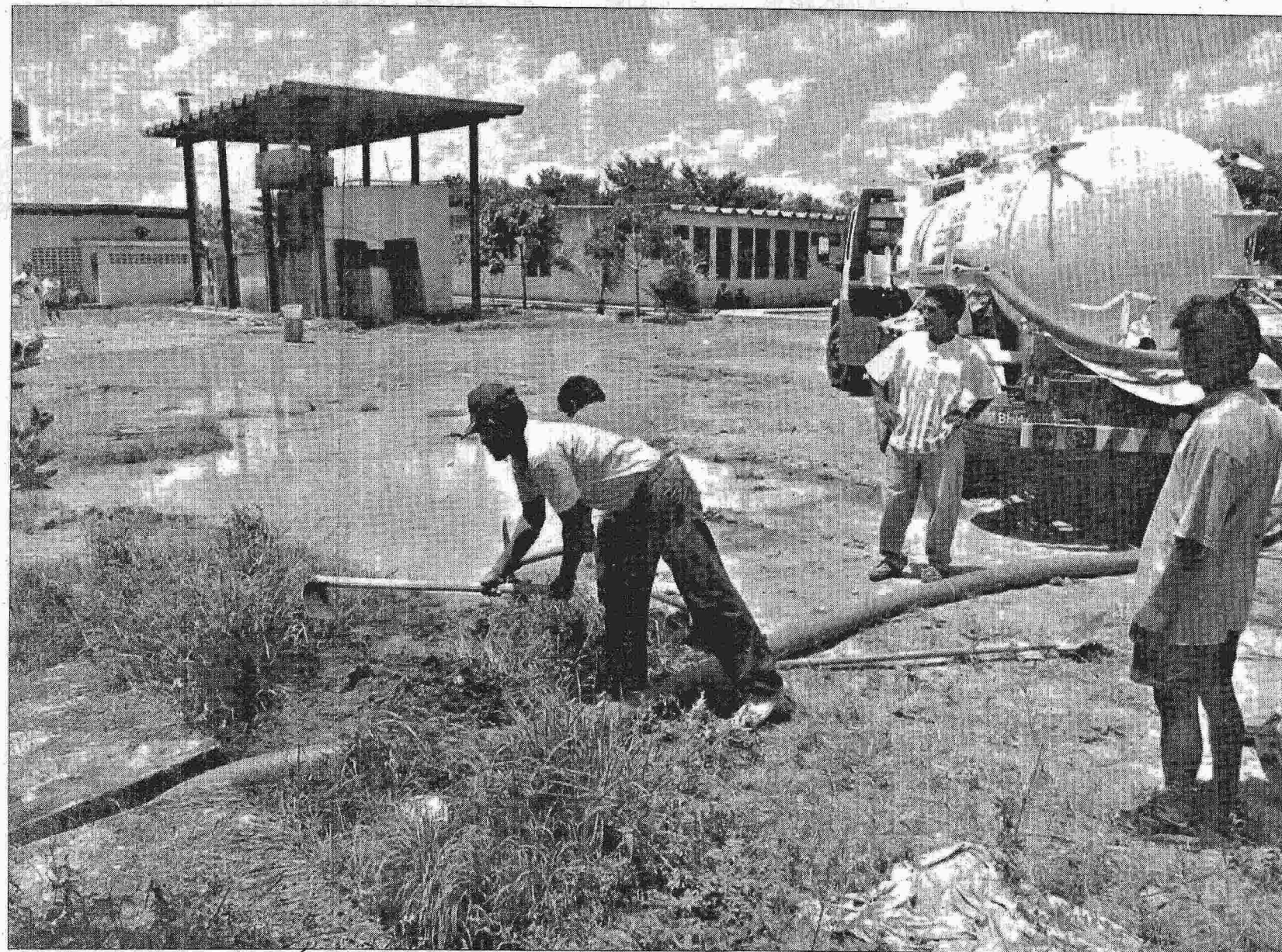
Funcionários da Companhia de Águas e Esgotos tentam limpar a fossa, que estourou há meses, formando um lago fétido na área em volta do hospital
