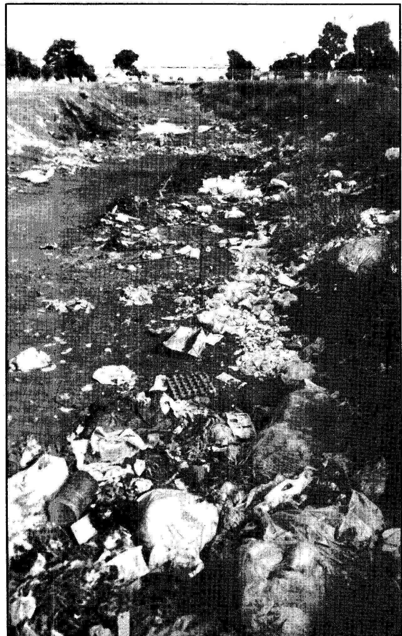
As valas para passagem dos trilhos viraram depósito de lixo
