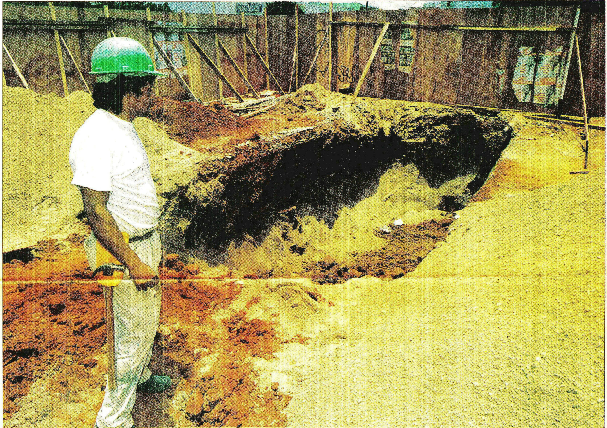
Em canteiro de obras na Praça do Relógio, operário mostra local onde o terreno cedeu e pegou de surpresa o colega de trabalho que, embaixo, instalava placas de metal para escorar paredes do túnel
