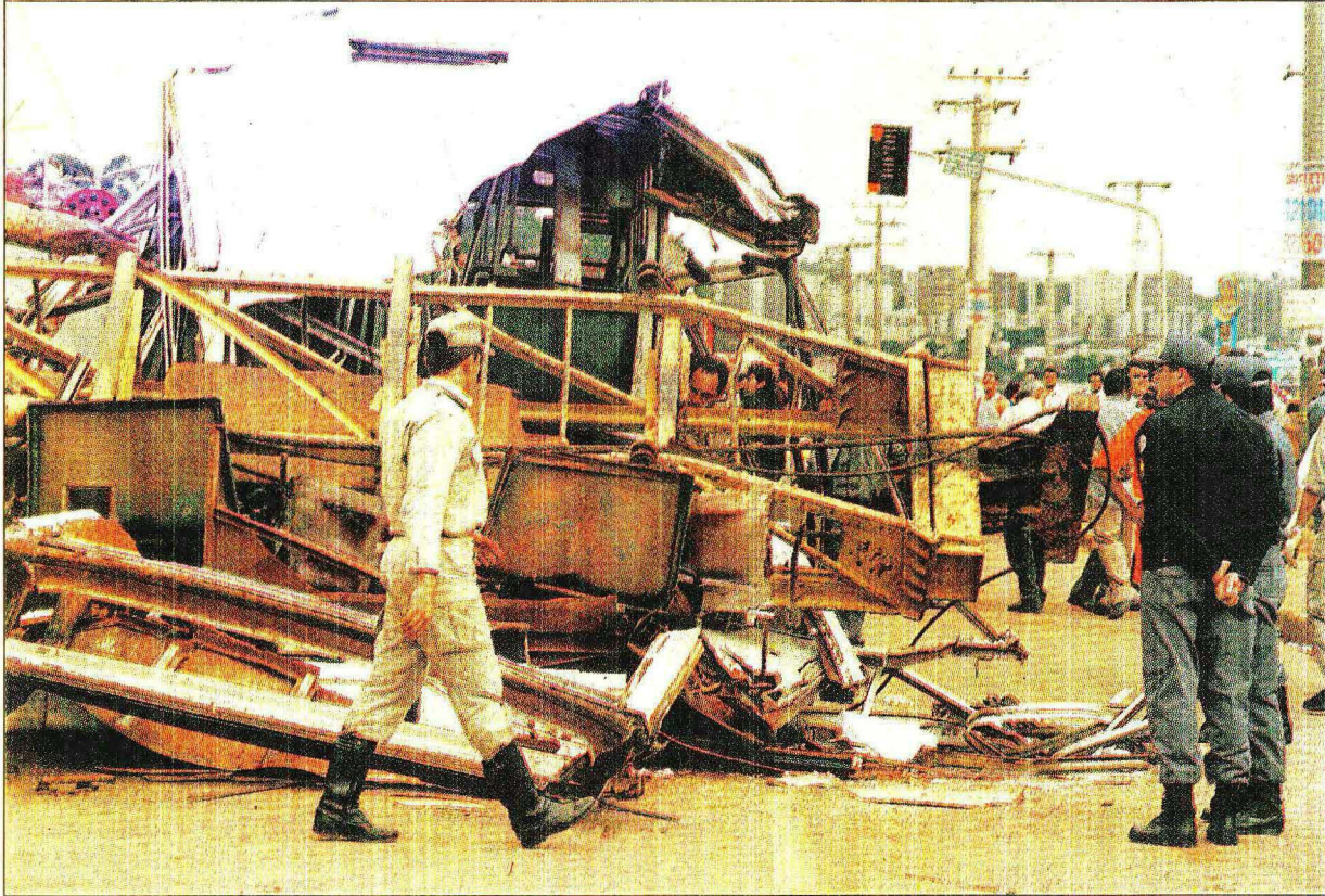
Viga de ferro que estava sendo içada pende para um lado e desequilibrou a máquina que estava há 10 dias no local
