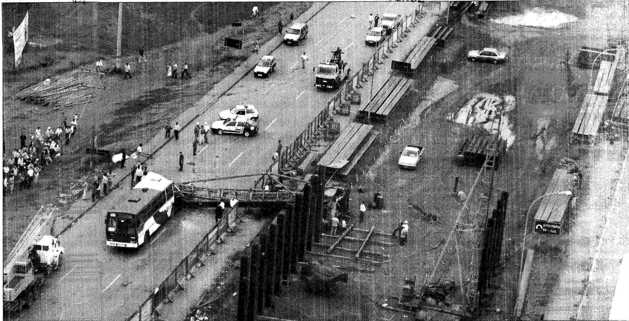
A segurança nos canteiros de obra do metrô não estão sob responsabilidade de nenhum órgão ou empresa. Na última terça-feira um bate-estaca caiu e matou três pessoas que estavam num ônibus
