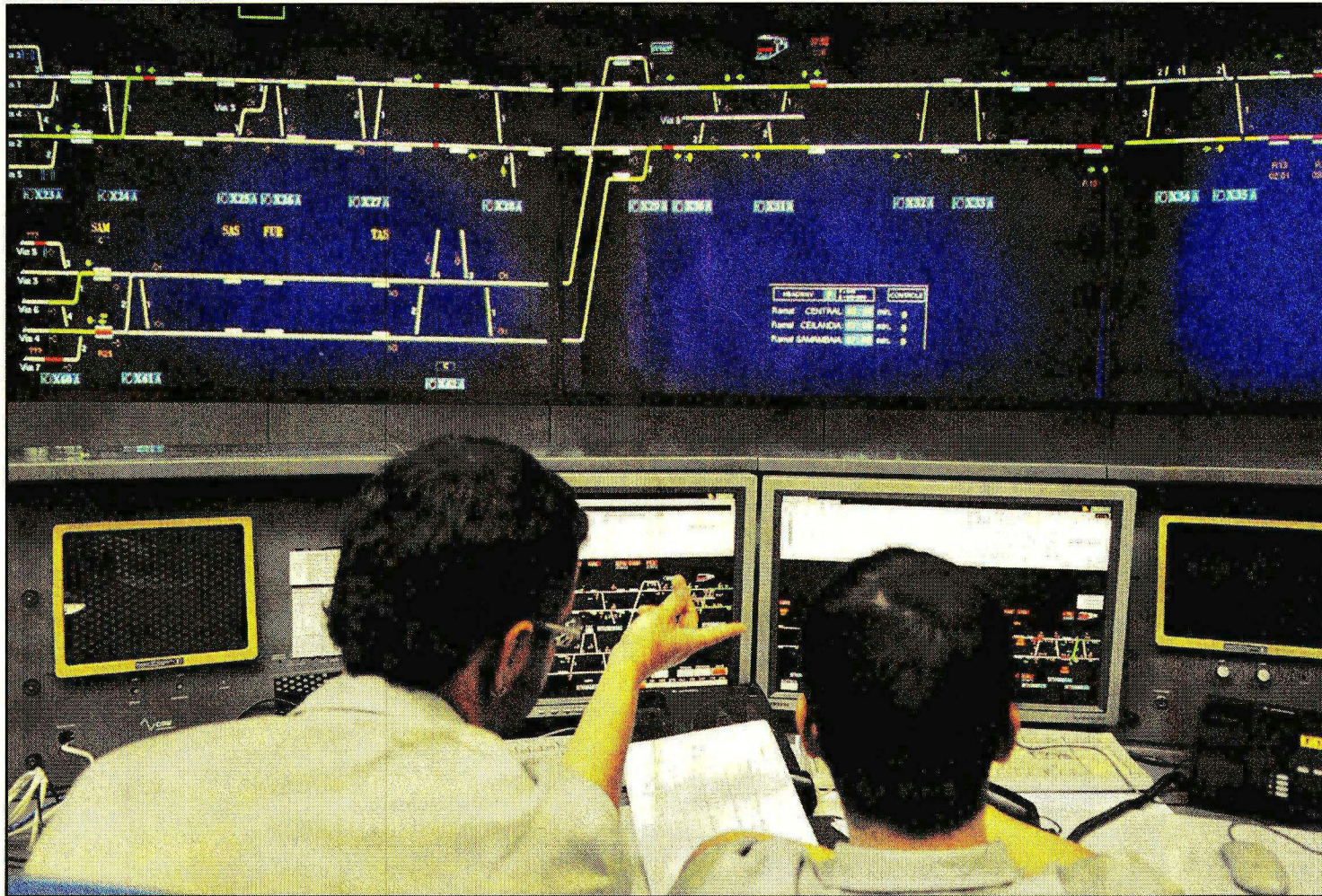
Centro de Controle Operacional do Metrô: local de onde partem determinações para a colocação dos trens em circulação
