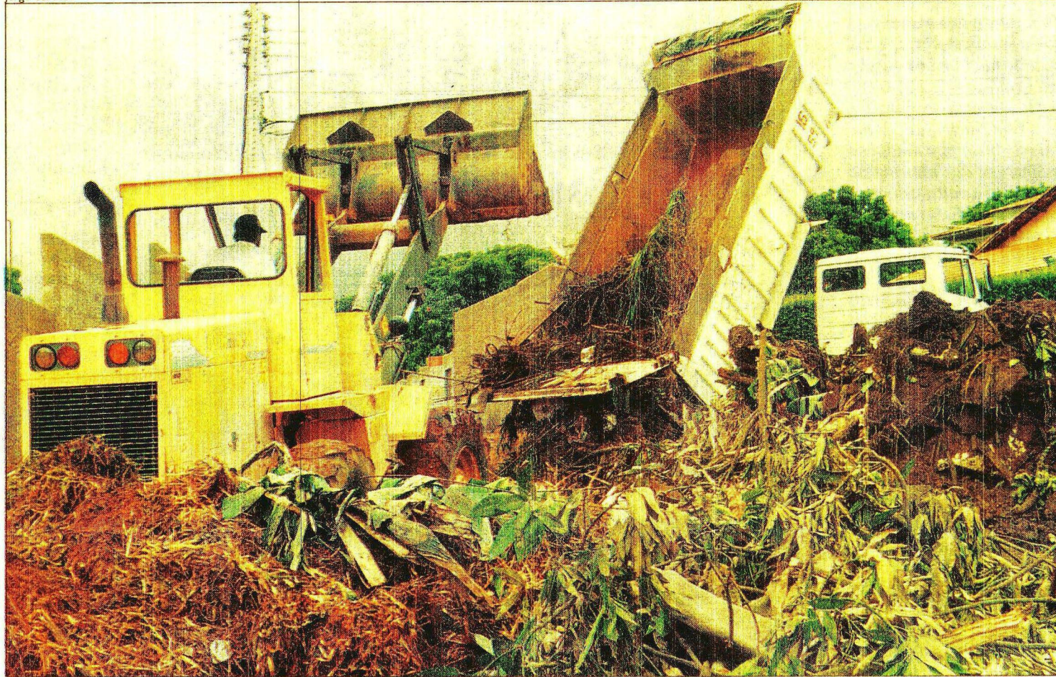
Caminhão traz o entulho e um trator da Administração de Taguatinga o espalha no local da erosão na Colônia Agrícola Samambaia
