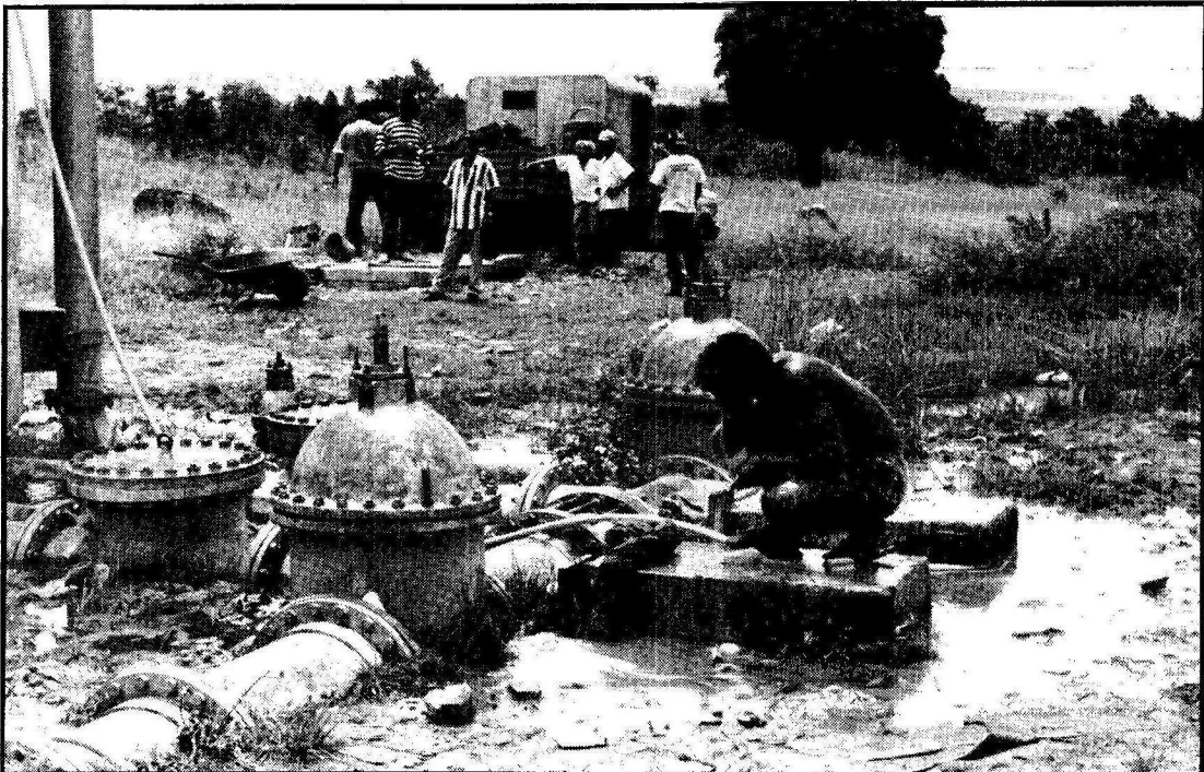
Os próprios moradores mostraram aos técnicos como utilizavam, irregularmente, a água
