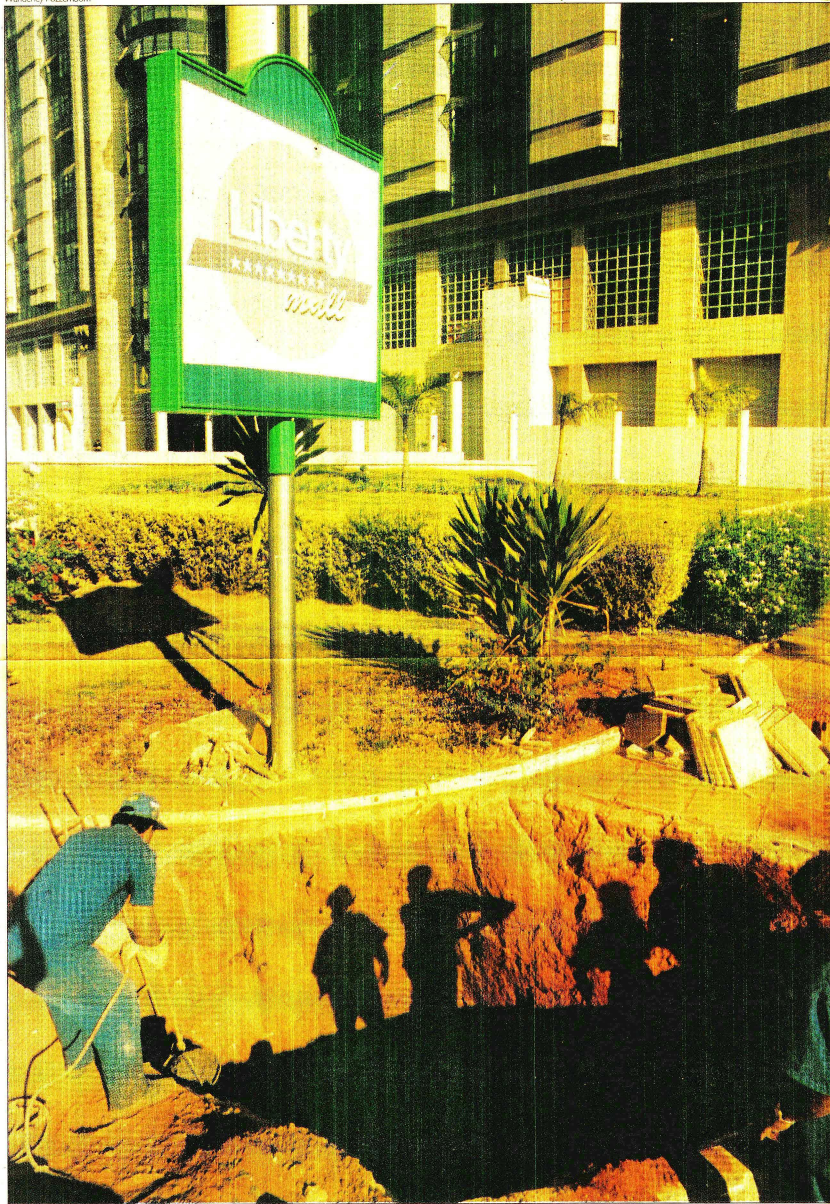
Do luxo ao lixo: só ontem os funcionários da Caesb repararam a rede pluvial que levava os esgotos do elegante Liberty Mall para o Lago Paranoá
