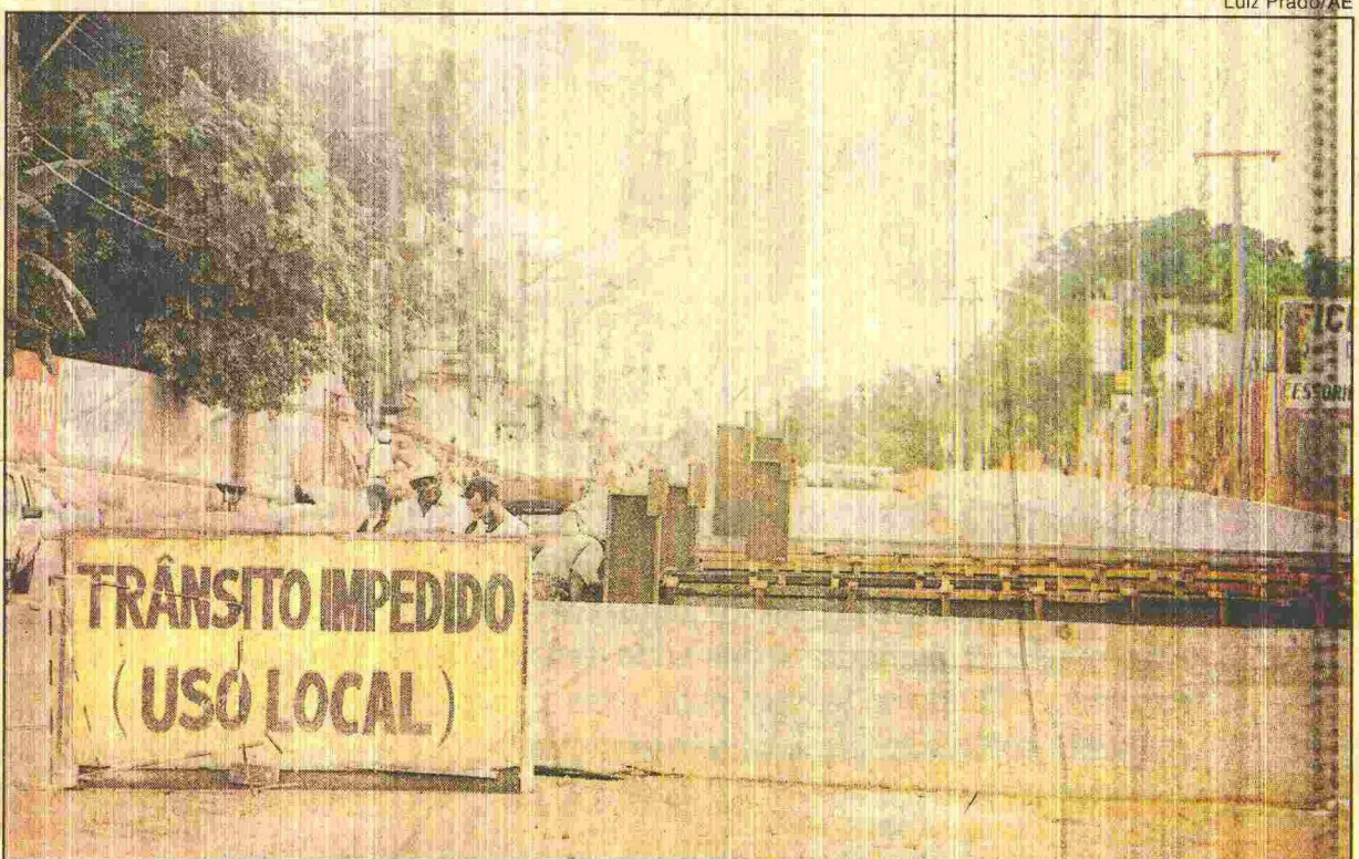
Av. Darcy Vargas: construção de prolongamento não foi concluída, mas empreiteiras receberam pagamento
