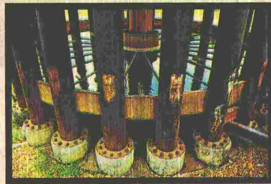
FERRUGEM E ÁGUA EMPOÇADA NO MASTRO DA BANDEIRA
