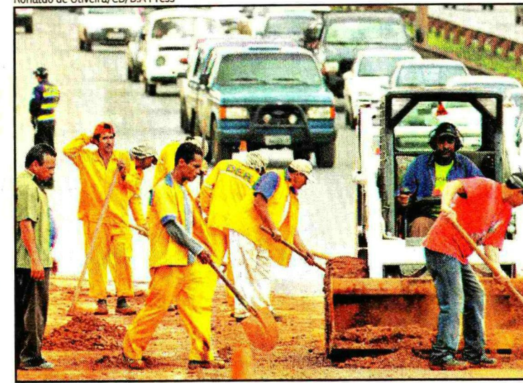
Na Via Estrutural, a lama invadiu parte da pista, interditada no Km 7
