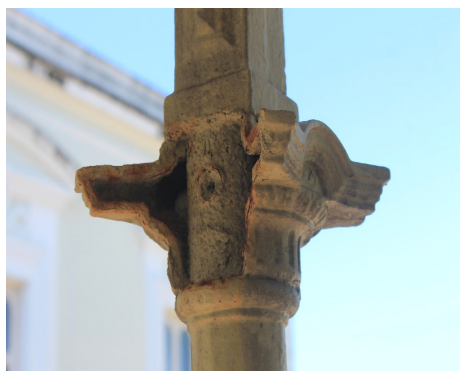
Figura 3.12 Lacuna resultante da perda de peça metálica.
