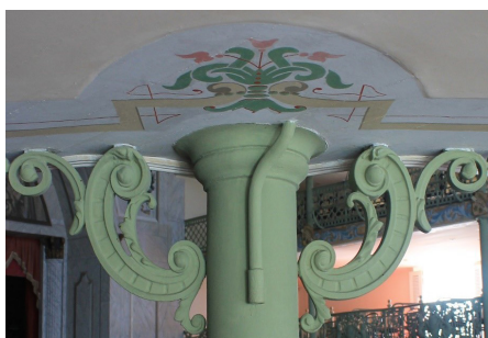
Figura 3.5 Tubulação remanescente da iluminação a acetileno.
