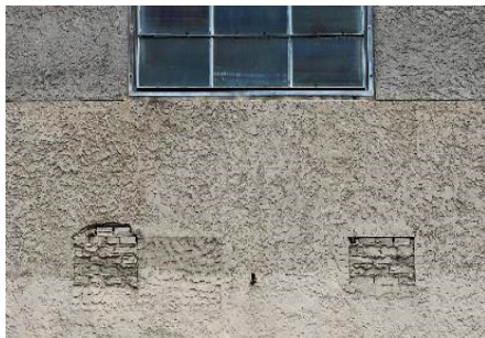
Figura 4.19 Detalhe da fachada leste. Revestimento da década de 1930, com lacunas, tentativas de recomposição e diferentes repinturas.
