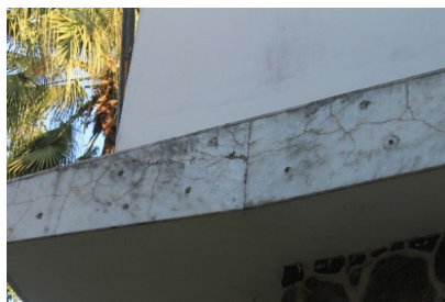
Figura 1.7. Revestimento de laje em mármore de Carrara. Marcas dos parafusos usados para fixação das peças.
