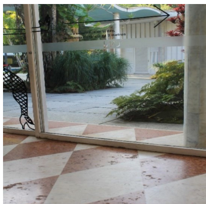
Figura 1.4. Piso da galeria do pátio. Observar desgaste do mármore rosso Verona.
