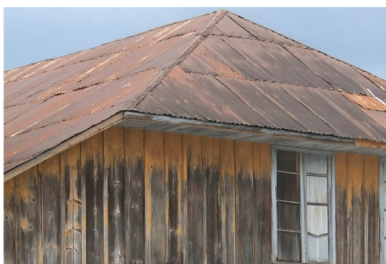
Figura 7.31 Cantina de vinhos. Fachada em tabuado de madeira, com perda parcial de pintura e alterações cromáticas resultantes da exposição aos agentes atmosféricos.
