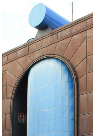
Figura 6.16 Marcação de rusticação no revestimento em chapas de aço na fachada sudoeste.
