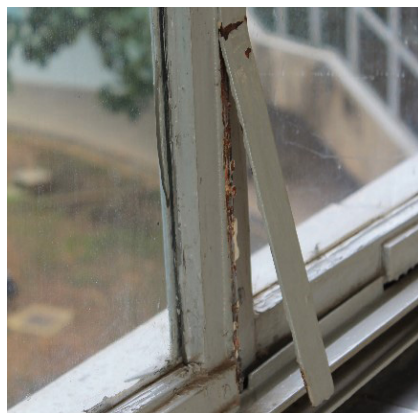
Figura 10.48 Caixilhos em aço. Situação de degradação.
