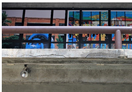
Figura 2.19. Sede da Companhia Hidrelétrica do São Francisco (Chesf), em Salvador. Fissuras ao longo das armaduras, possíveis indícios de degradação avançada.
