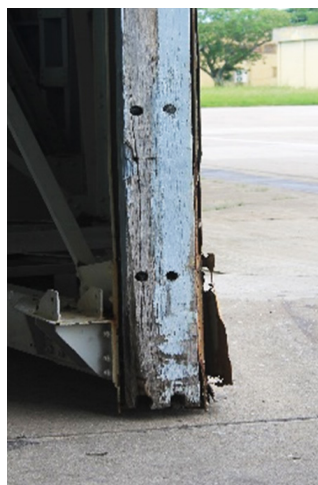
Figura 4.20 Batedor de uma das portas colossais. Perda de pintura, lacunas e abertura de fibras. Peça diretamente associada ao uso dos dirigíveis.
