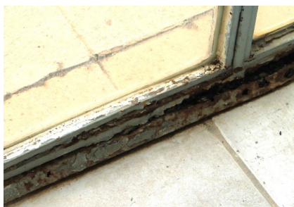
Figura 10.47 Caixilhos em aço. Situação de degradação.
