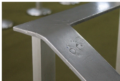
Figura 5.30 Palácio do Congresso, Edifício Principal. Guarda corpo da escadaria do Salão verde, em aço inoxidável, com marcas associadas à execução e ao uso continuado.
