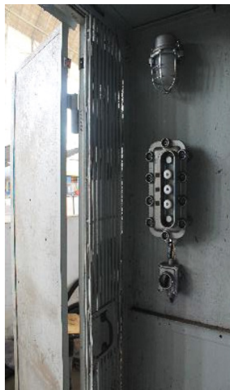
Figura 4.8 Elevador de passageiros e de carga, com seus elementos de fechamento, controle e iluminação iniciais.
