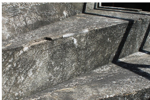
Figura 1.20 Instituto Cultural da Aeronáutica, Rio de Janeiro, 2021. Piso da escada externa, em estado crítico. Placas delgadas de mármore com 1cm de espessura, com colonização biológica, fissuração, fragmentação, destacamento e lacunas.
