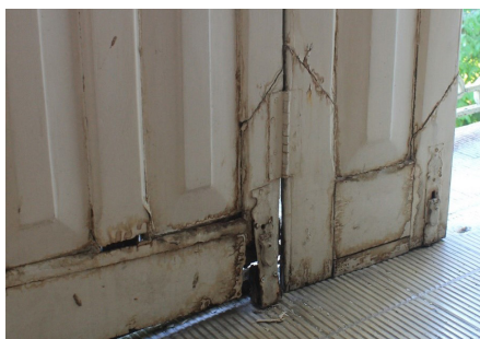
Figura 3.7 Esquadrias da fachada lateral. Marcas de substituição parcial e de degradação, que requer novas substituições parciais.
