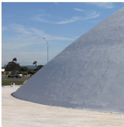
Figura i.2. Palácio do Congresso Nacional. Cúpula do Senado Federal, 2022. Irregularidade da superfície, associada a ações de manutenção acumuladas.
