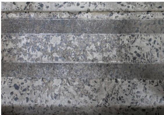
Figura 2.24. Sociedade Harmonia de Tênis. Degraus em concreto aparente, com agregado exposto, e padrão de desgaste com numerosas pequenas lacunas, associado ao uso.
