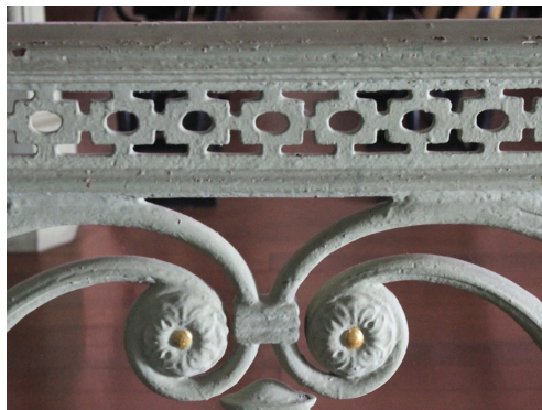
Figura 3.10 Textura adquirida pelo do acúmulo de repinturas nos guarda-corpos.
