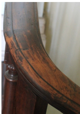
Figura 7.28 MIS-RS. Guarda-corpo da escada remanescente, com arranhões, lacunas e alterações cromáticas associadas ao uso.
