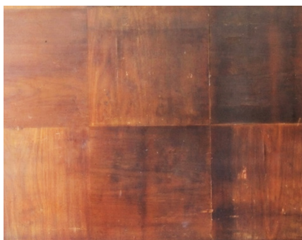
Figura 5.14 Lambri do foyer superior, com fissuras e alterações cromáticas.
