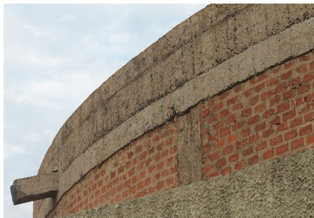
Figura 2.22 Igreja do Divino Espírito Santo, em Uberlândia. Concreto recentemente limpo, com marcas de execução e difícil identificação de alterações no tempo.
