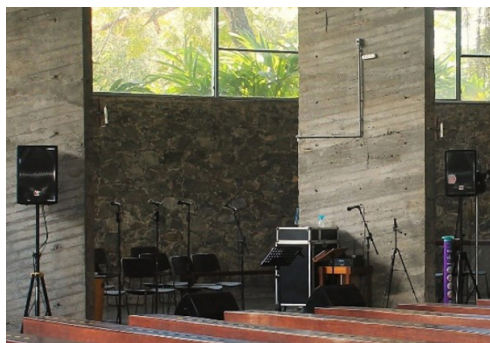
Figura 8.38 Alterações na nave. Tubulação para instalações elétricas, sonorização improvisada.
