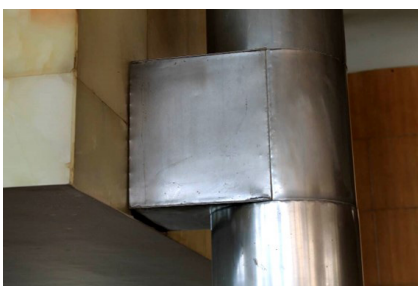
Figura 10.42 Pilar da galeria e console de sustentação do mezanino. Marcas do acabamento e fixação das folhas de aço inoxidável.
