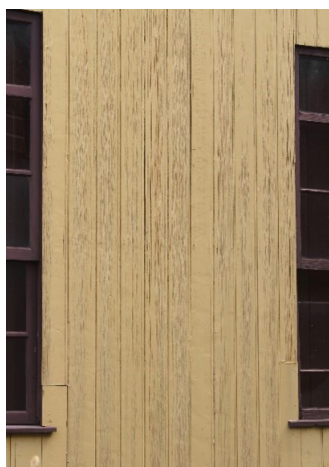
Figura 7.30 Casa da Neni. Textura da madeira da fachada, visível apesar das repinturas.
