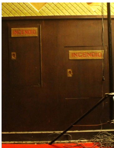
Figura 5.12 Armários para instalações de combate a incêndio na sala de espetáculos.
