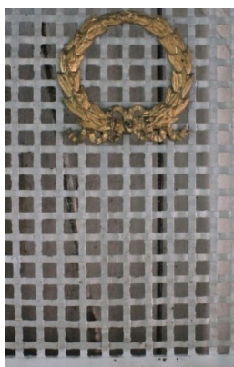
Figura 5.14 Lambri do foyer superior, com fissuras e alterações cromáticas.
