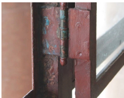
Figura 5.16 Esquadrias de aço do foyer superior, com oxidação e superfície repintada irregular.
