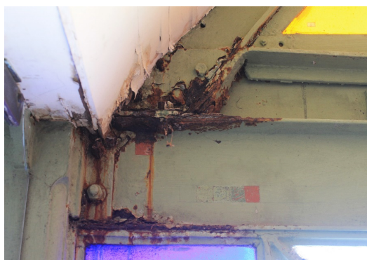
Figura 3.11 Ponto crítico de oxidação e corrosão em junta estrutural.
