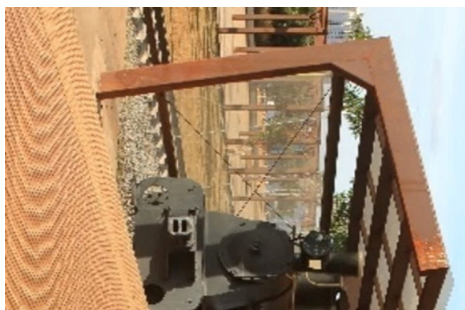
Figura 4.34 Casa da Cultura de Pires do Rio (antiga estação ferroviária). Textura resultante das sucessivas repinturas sobre as ferragens.
