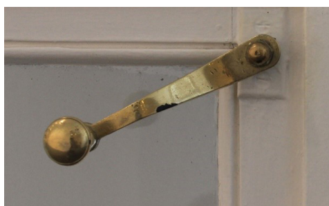
Figura 1.13 Instituto Moreira Salles. Alavanca das esquadrias. Observar arranhões e oxidação pontual.
