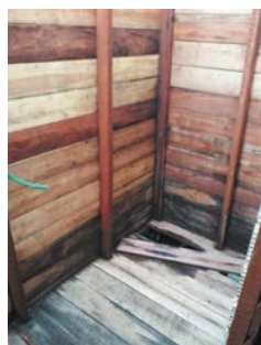
Figura 33: Banheiro apenas com fresta no piso para escoar água do banho. Não há vaso sanitário nem lavabo para higiene
