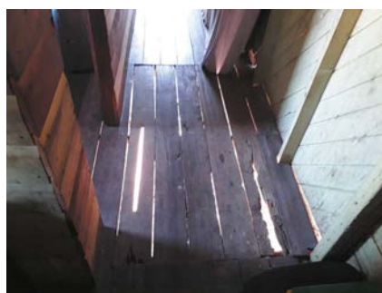
Figura 13: Piso precisando de reforma.
