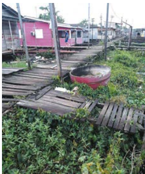
Figura 22: Passarela com tábuas soltas.
