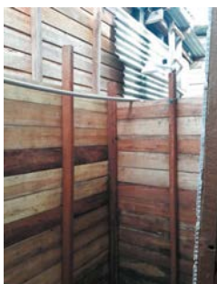
Figura 32: Chuveiro em banheiro sem cobertura.
