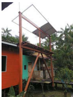
Figura 67: Instalações fotovoltaicas desativadas temporariamente.
