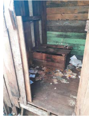
Figura 40: Sanitário coletivo com lixo jogado no chão. Foto: Melissa Matsunaga, 2018.
