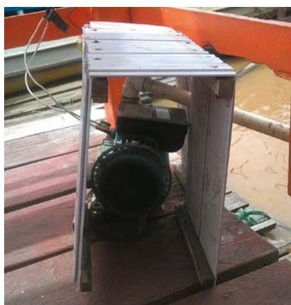
Figura 76: Bomba utilizada para retirar água do rio.
